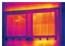
Bâtiment : déperdition énergétique
